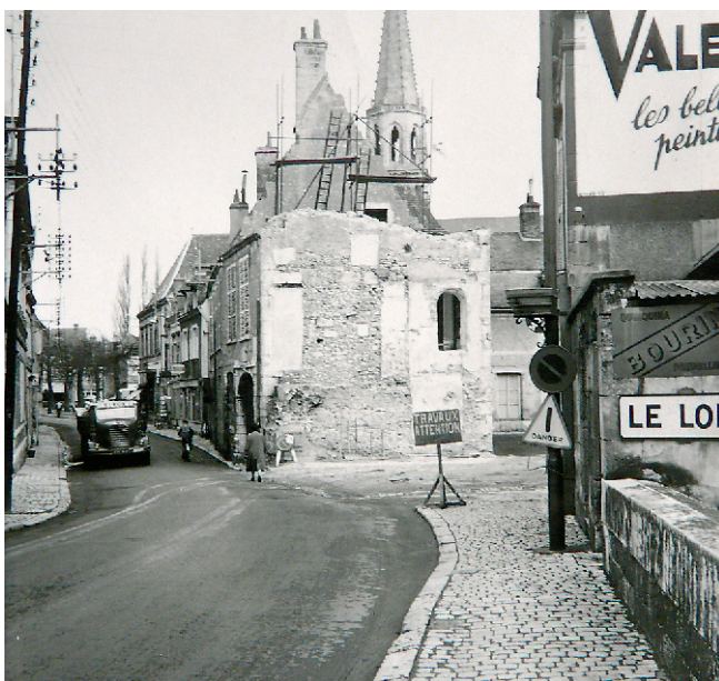
Fig. 29 : Les travaux de démolition de l'Hôtel de Gennes en cours d'achèvement, photographie prise depuis la rue (Médiathèque du Patrimoine).
