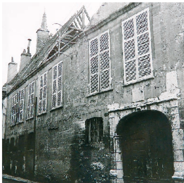
Fig. 28 : Poursuite de la démolition par le démontage de la charpente (coll. ISV).
