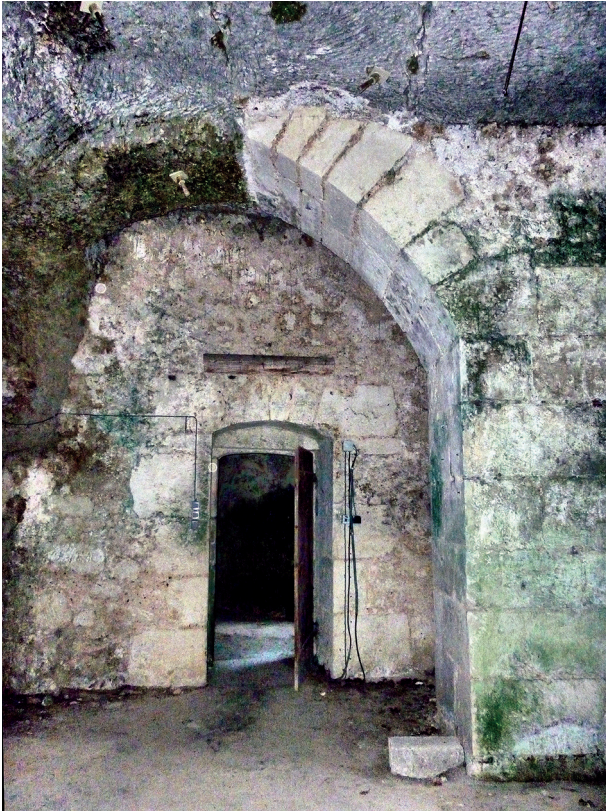
Fig. 6 : Entrée et arc de soutènement du corps de garde (B) situé à l'entrée des souterrains du premier palier du promontoire.
